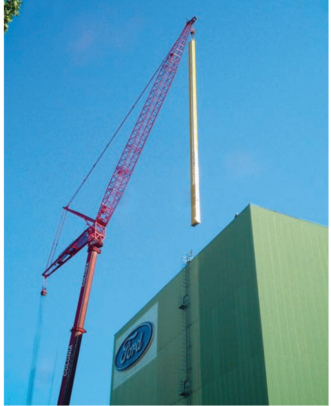
Den spezifischen Anforderungen bei Modellwechseln im Automobilbereich müssen Regalbediengeräte standhalten. Das Bild zeigt das Einbringen eines Regalbediengerätetests in das Lager.
